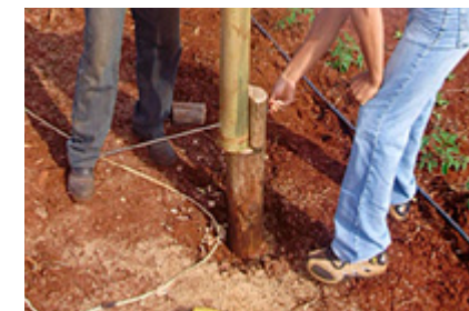
Evitar apoiar direto no chão.
